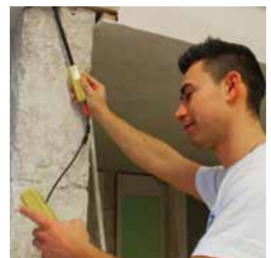
Stuckateur beurteilt Bauschäden.
